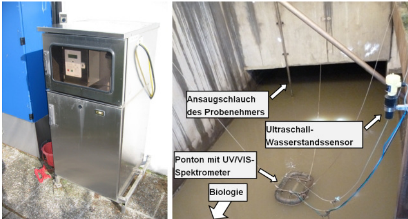
Abbildung 111: Probennehmer MAXX SP5 A beim Ablaufbauwerk der Vorklärung auf der RKL Linz-Asten
