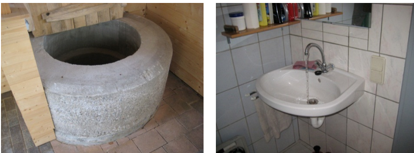
Abbildung 98: Schachtbrunnen der GZÜV-Messstelle PG54205822 und Probenahmestelle
