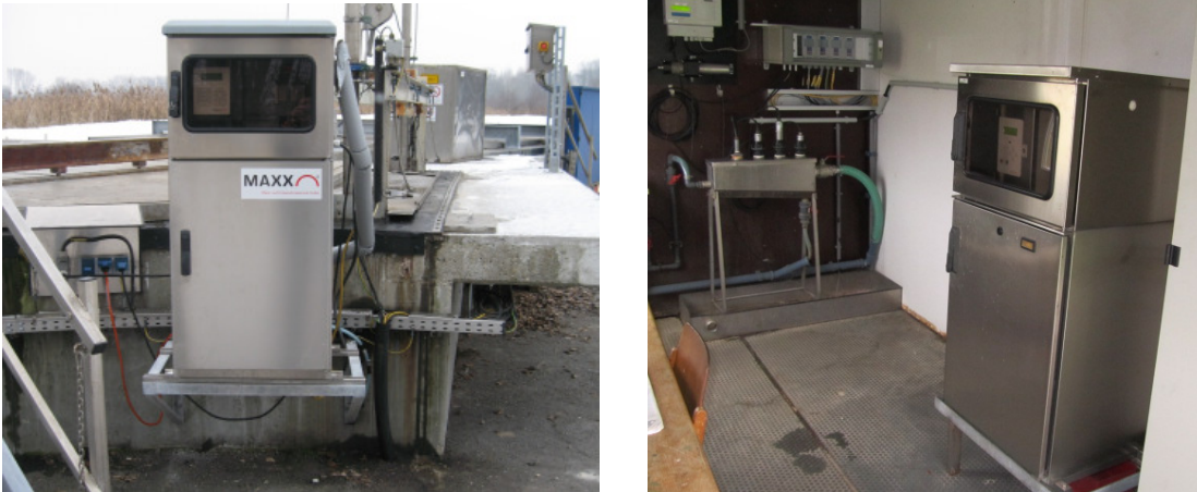
Abbildung 114: Standorte der Probenehmer der RKL Linz-Asten beim Zulauf (links) und beim Ablauf der Kläranlage – Durchflussmessung Biologie 1-8 (rechts)
