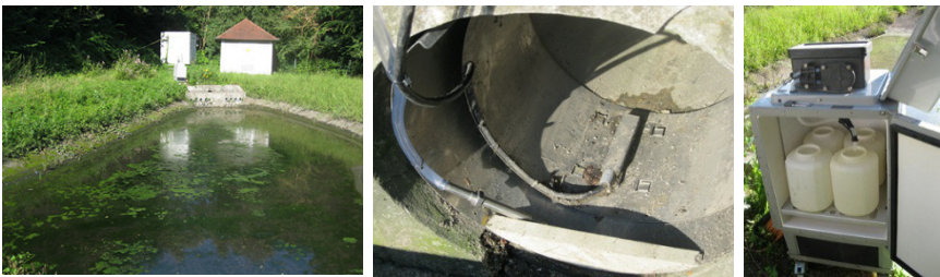
Abbildung 91: Autobahnregenbecken Mönchgraben – Sedimentationsbecken, Durchflussmessung im Zulauf zum Sedimentationsbecken und installierter Probenehmer.
