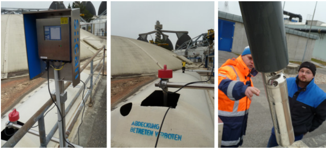
Abbildung 77: Sensorstandort „pcin“ im Zulauf zur Vorklärung der RKL Linz-Asten
