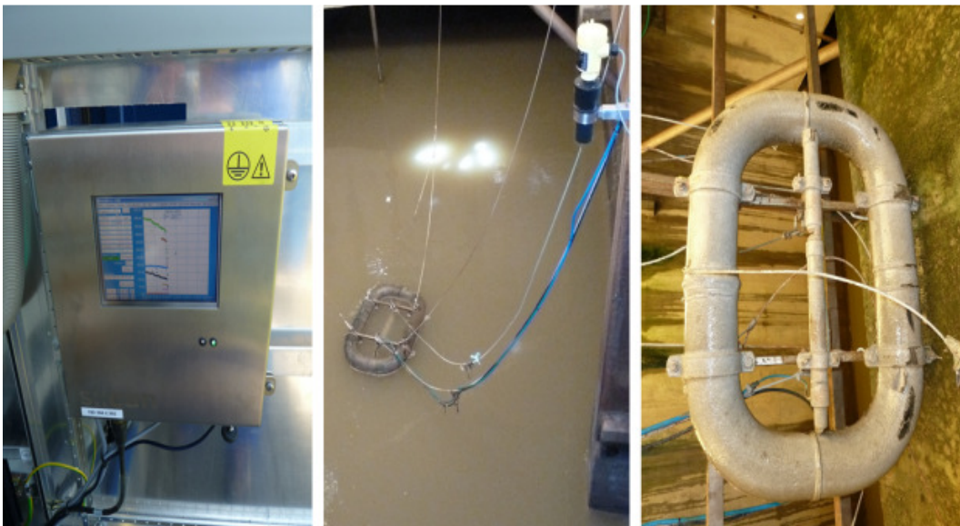
Abbildung 78: Sensorstandort „pcout“ im Ablauf der Vorklärung der RKL Linz-Asten im Bereich der Mischwasserentlastung
