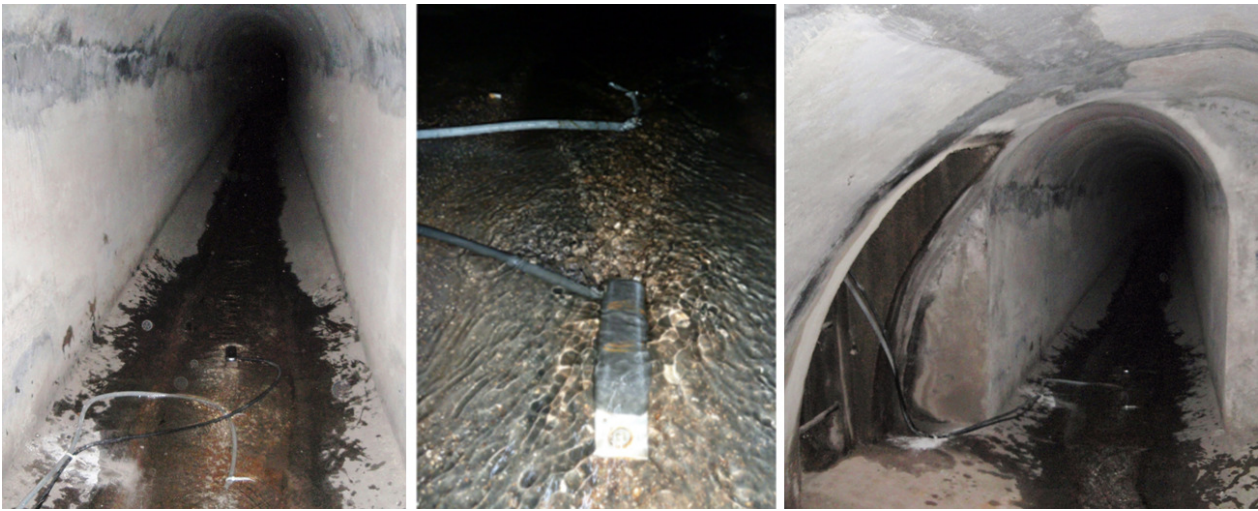
Abbildung 84: Profil des untersuchten Niederschlagswasserkanals mit installiertem Durchflussmesssystem und Probenahmeschlauch
