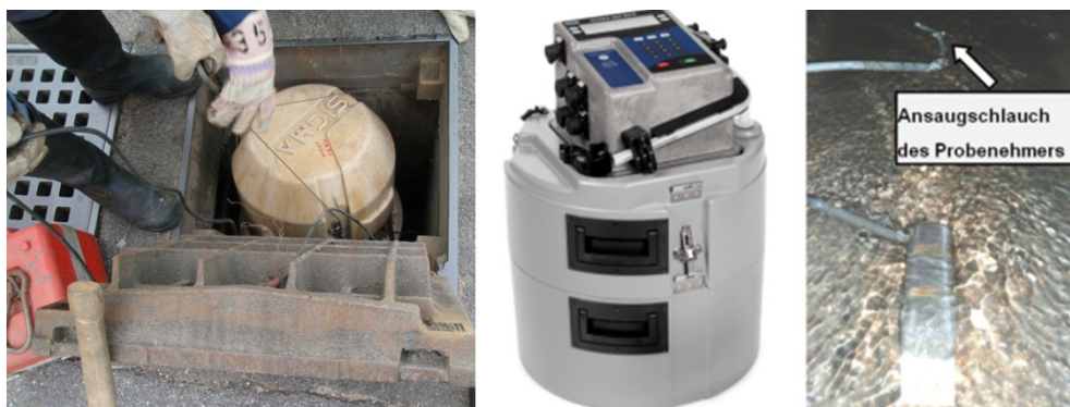
Abbildung 113: Probenehmer Sigma 900 MAX (portable) im Schacht eines Niederschlagswasserkanals in einem Siedlungsgebiet im Osten Österreichs
