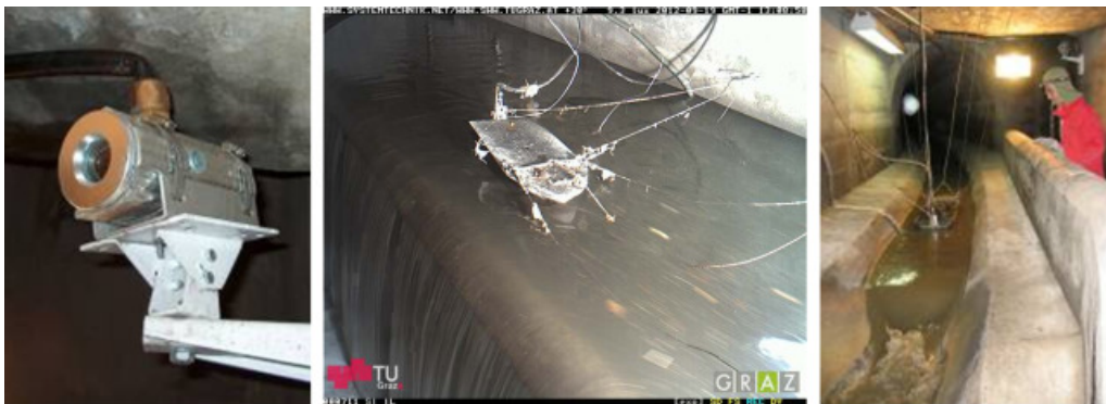
Abbildung 58: Videokamera und Beleuchtung zur Kontrolle und Aufzeichnung von Mischwasserereignissen der MS Graz
