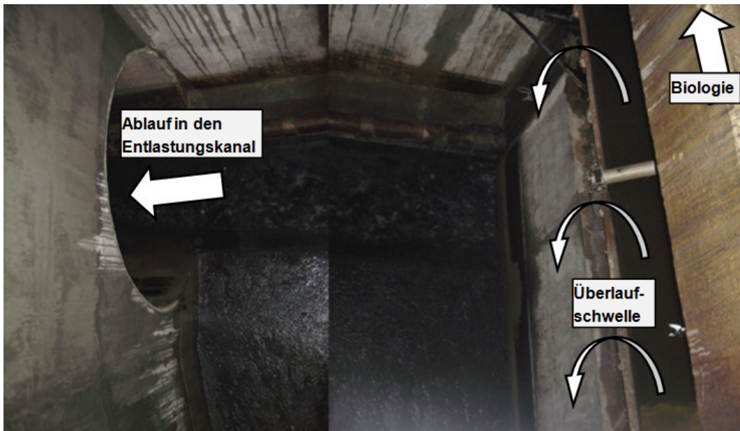
Abbildung 79: Mischwasserüberlaufbauwerk am Sensorstandort „pcout“ im Ablauf der Vorklärung der RKL Linz-Asten
